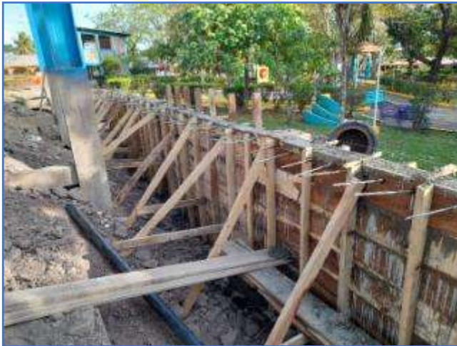
En la fotografía supervisión en el sitio de la obra, se observa la llena del Muro MR-1 en área de gradería en Cancha Multiusos.
